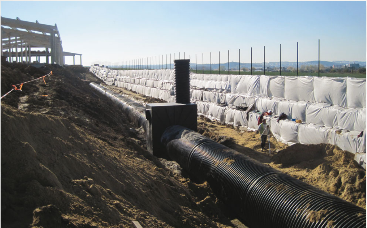
Retenční nádrž z potrubí DN 2000 se středovým výtokem opatřeným vírovým ventilem (dálnice R1 Nitra – Tekovské Nemce, Slovensko).
