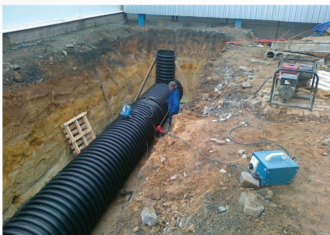
Bezpečnostní nádrž na ropné látky v případě havárie. Zde je klíčová absolutní dlouhodobá těsnost, která se dá ověřit opakovaně tlakovou zkouškou (areál firmy Kopos v Kolíně).
