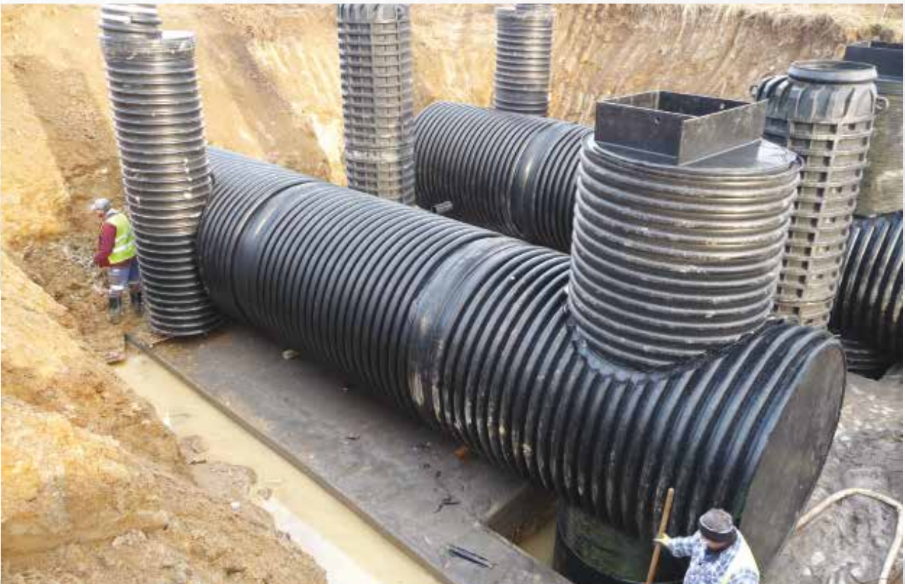
Vodojem s kapacitou 53 m 3 ze dvou potrubí DN 2000 včetně vstupů a kalových jímek (Mitrovce na Táborsku).
