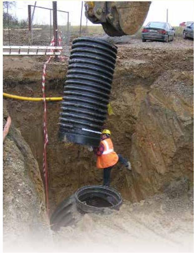
U větších hloubek je vstupní komín rozdělen a jeho montáž se provede až na stavbě pomocí hrdlového spoje.
