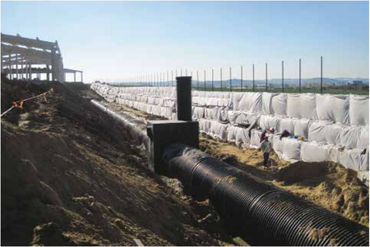
Retenční nádrž z potrubí DN 2000 se středovým výtokem opatřeným vírovým ventilem (dálnice R1 Nitra – Tekovské Nemce, Slovensko).
