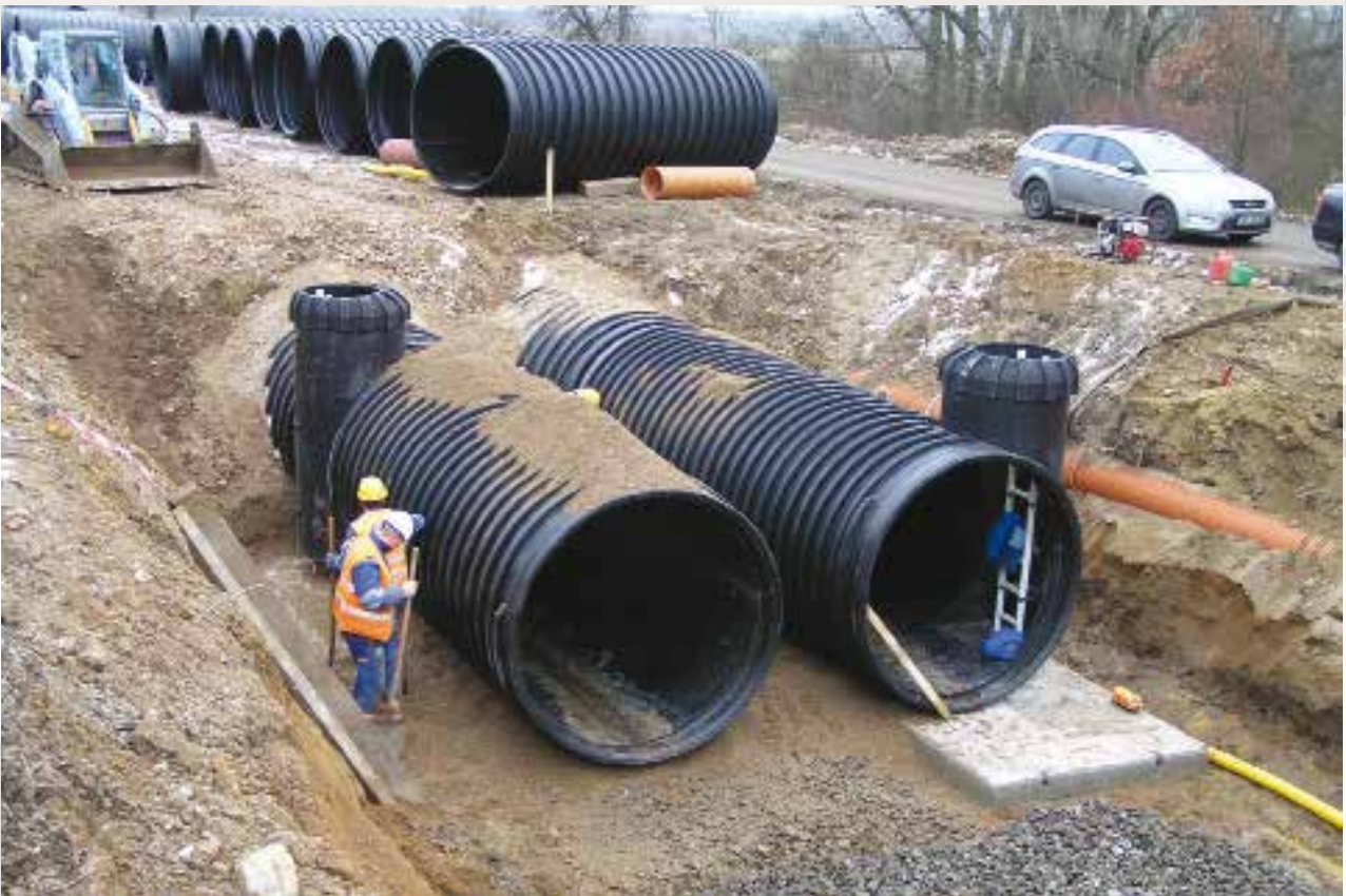
Retenční nádrž ze dvou potrubí DN 2000 s ruksakovými vstupními šachtami (dálnice R7, Břtzeves – Vysočany).
