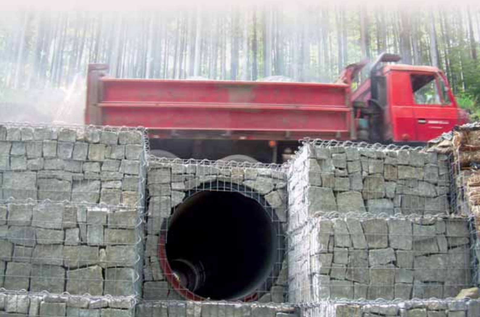
Detail provedení kolmého ukončení propustku z potrubí Uporol DN 1000 v gabionové zdi
